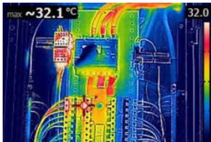
Рисунок 1 – Приклад термограми тепловізійного обстеження електрообладнання
