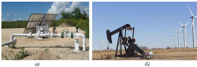
а) дистанційний моніторинг та регулювання режиму роботи технологічних трубопроводів (компанія AmerescoSolarSolutions); б) нафтовий насос і вітрові турбіни на нафтовому родовищі у Західному Техасі Рисунок 5 - Розміщення обладнання відновлювальної енергетики на нафтогазоносних ділянках
