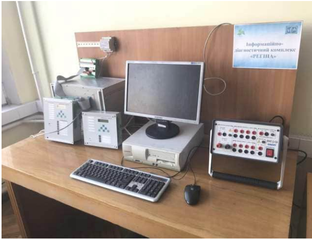
Рис. 10 – Лабораторія автоматизованих систем моніторингу та керування системами електропостачання
